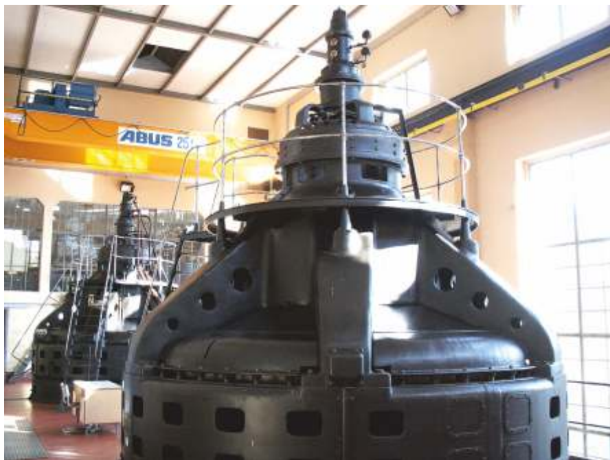
Generatory ASEA w hali maszyn elektrowni w Żurze (fot. Mariusz Chudecki)
